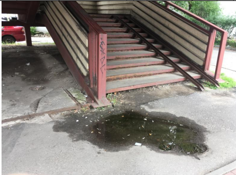
UL. SOBIESKIEGO- USZKODZONA NAWIERZCHNIA PRZY KŁADCE
