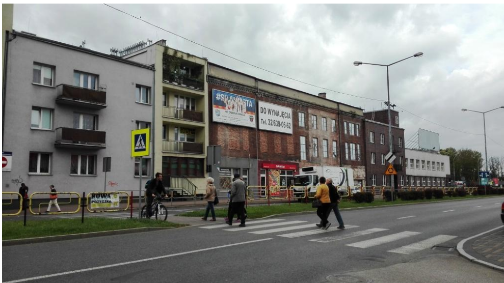
UL. KOŚCIUSZKI- ZANIEDBANE ELEWACJE BUDYNKÓW
